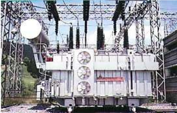
Anexo 10. Transformador de potencia
