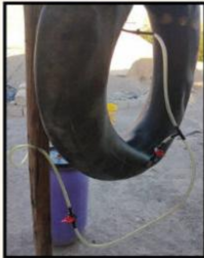
Figura 5. Tubo T que une al biodigestor con la cámara y salida del biogas
