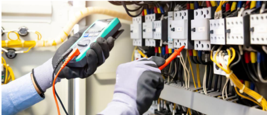
Sistema de protección y control
