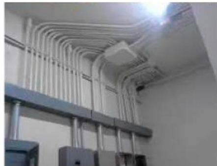
INSTALACIÓN VISTA SOBREPUESTA EN CUARTO ELÉCTRICO
